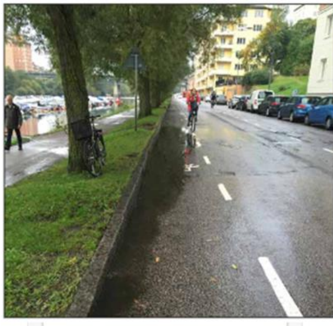
Figur 25 Regnvatten på vägrenen
